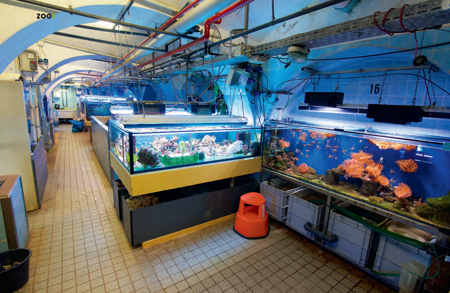
Der Bereich hinter den Seewasserbecken: ein komplexes System aus Leitungen und Rohren.
